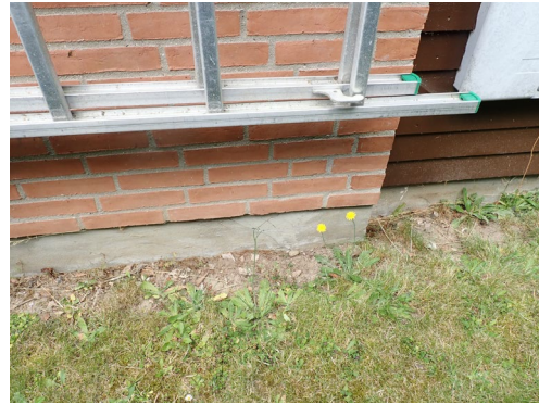
Foto: Revner og afskallinger i sokkel pudsen.
