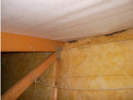
Foto: Ingen ventilation ved lodret væg i tagrummet.
