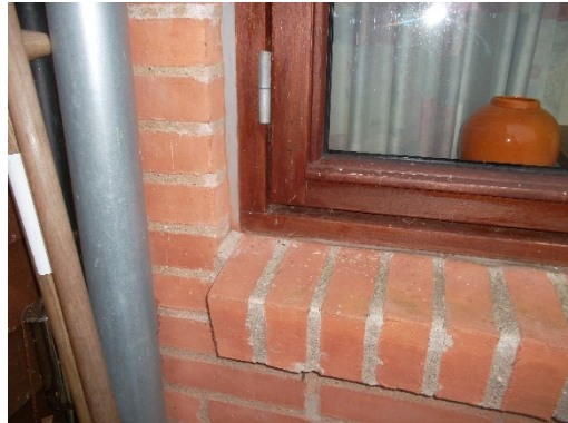
Foto: Elastisk fuge under et Mahogni vindue
